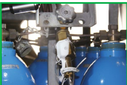
Comprobación de uniones roscadas
